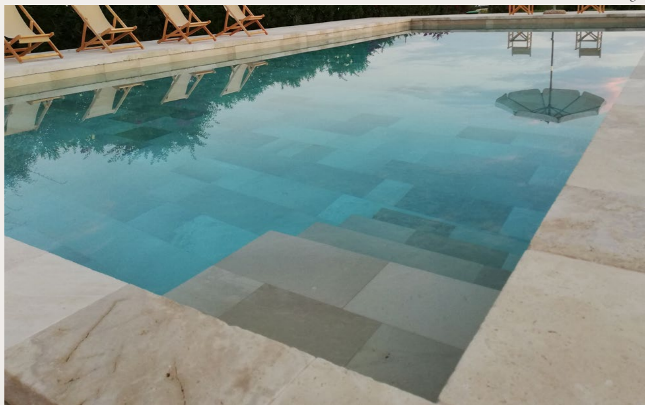
Pavimento interno e esterno taglio sega 30cm a correre | Internal and external floor saw cut 30cm free length
